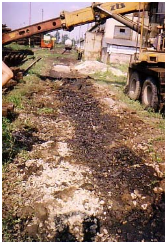
Pôvodný stav pred sanáciou
